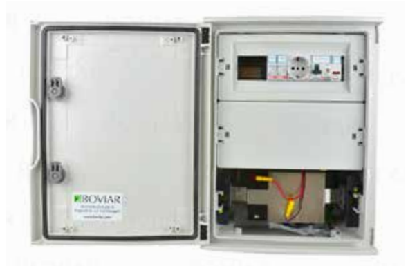
Figura 3 - Box di alimentazione da rete elettrica 220 V
